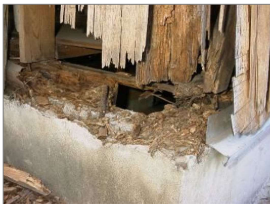
資料4. しらありの害が発生し、欠損している状態
