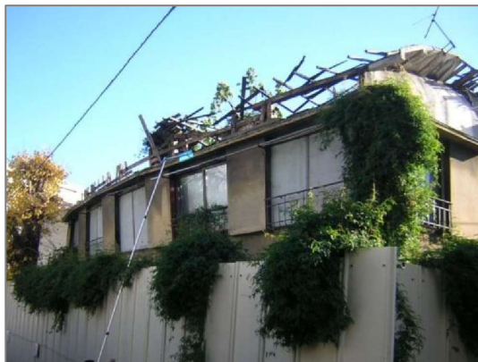
資料3. 屋根及び2階の床がなく立木等が繁茂し、景観を損なっている状態
