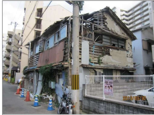
資料 1. 倒壊等により通行人等に影響するおそれがある状態
