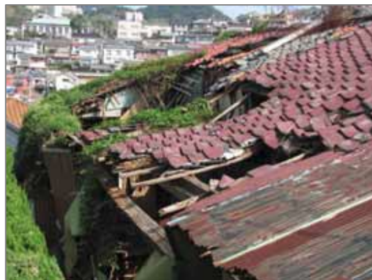
資料 2. 屋根の一部を備えないことにより、風雨、動物、害虫等が容易に侵入する状態
